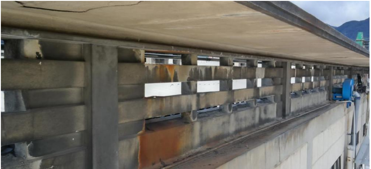
Ilustración 13 Ático tercer piso, se evidencias pérdidas de material, eflorescencias, manchas de óxido y humedad.
