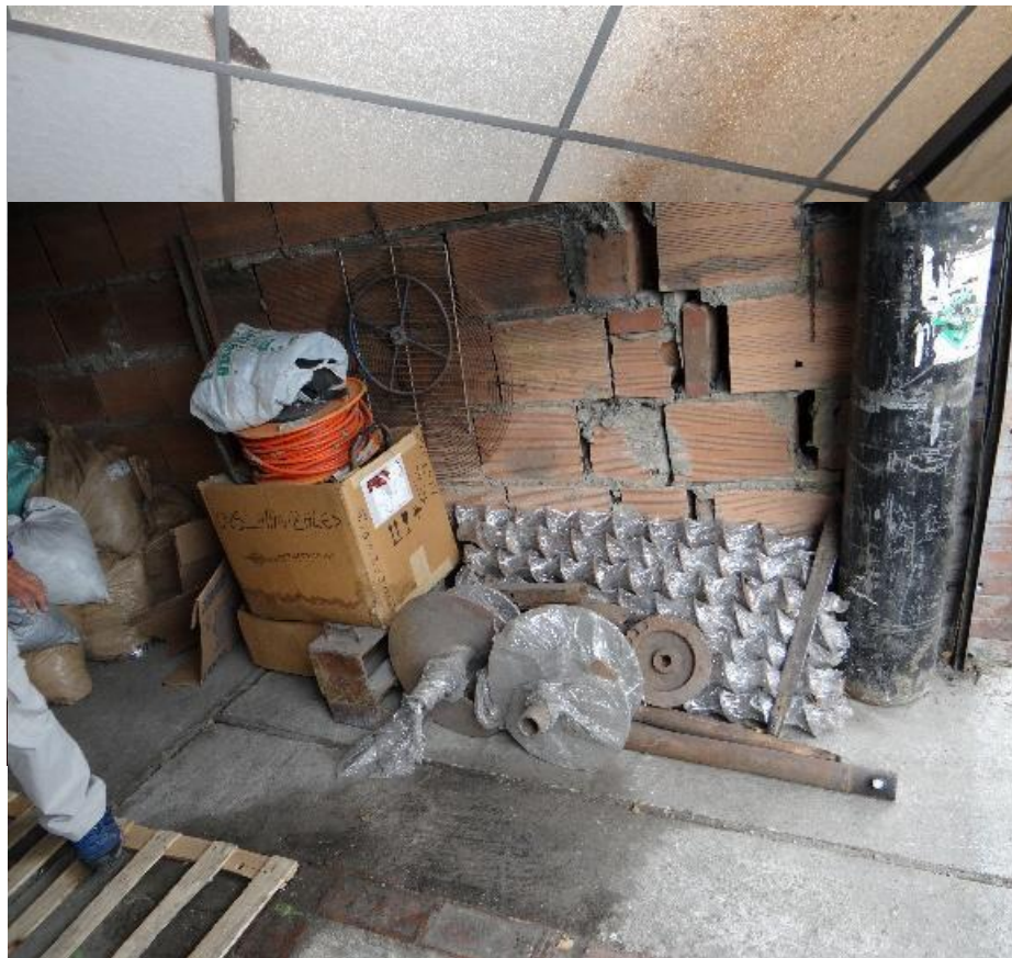
Ilustración 34. Muro deteriorado en bodega. Bloque D
